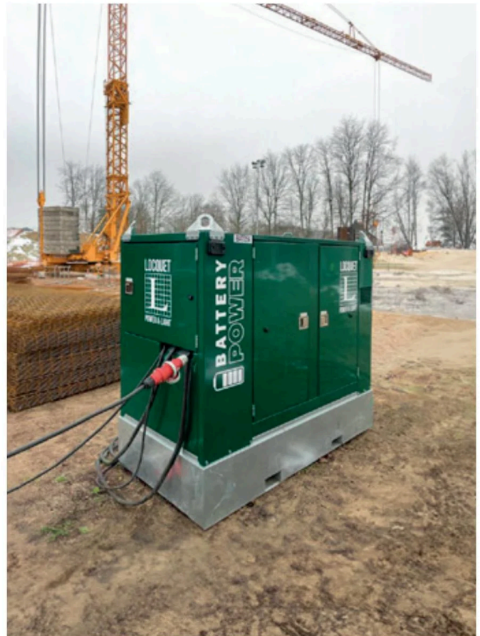
Powerbooster-batterijsysteem om stroompieken op te vangen, een alternatief voor de gasoliegenerator op de werf.
