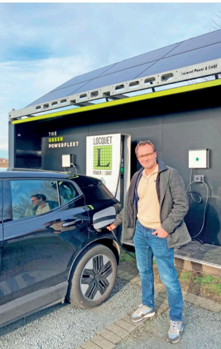
Op de parking van de hoofdzetel in Kruisem stelt Locquet Power & Light een DC-lader van 80 kW en twee AC-laders van 22 kW ter beschikking.
